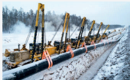
Магистральный газопровод Сила Сибири
