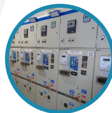
Комплектные распределительные устройства
