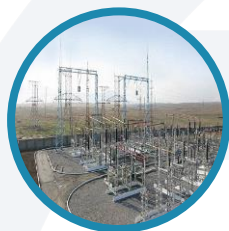
Оборудование высокого напряжения
